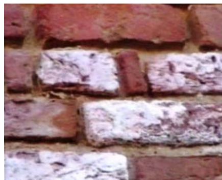
Efflorescenze saline su mattoni a vista che necessitano del trattamento Mursan® M 21 + M 22
