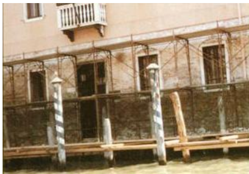
Palazzo veneziano sul Canal Grande di interesse storico con gravi problemi dovuti alle condizioni di intensa umidità
