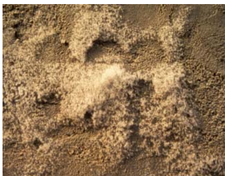
Efflorescenze saline su intonaco che necessitano il trattamento con Mursan® M 21
