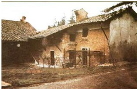
Fabbricato rurale le cui murature sono interessate da umidità di risalita capillare
